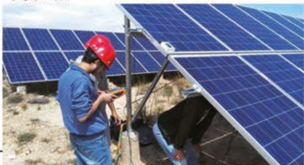
对组串进行故障组件排查
